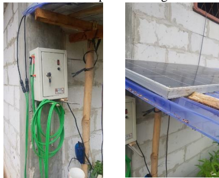
Instalasi Pompa Air Tenaga Solar
